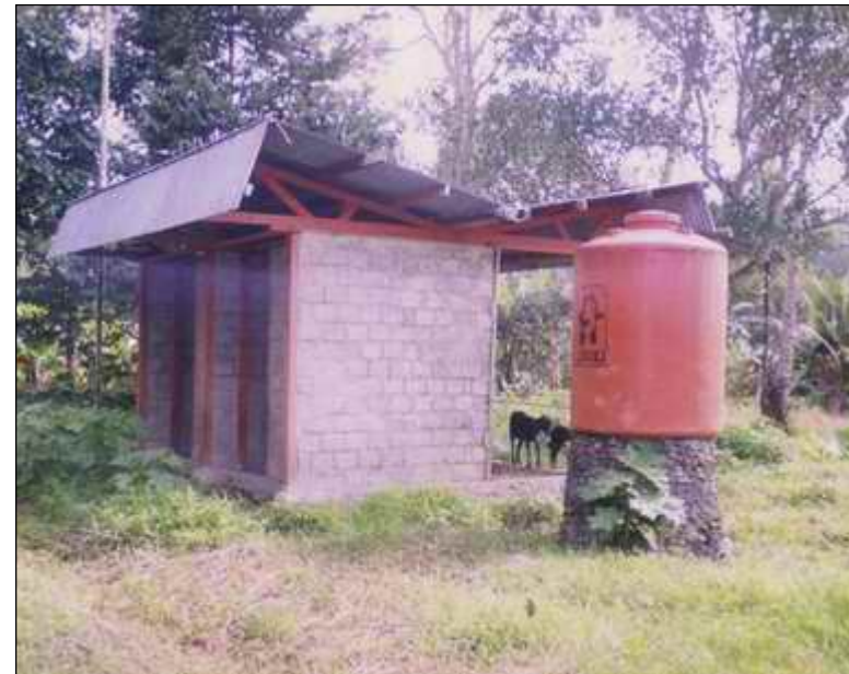
Sarana MCK yang tidak dapat dipergunakan di kampung Werabur
